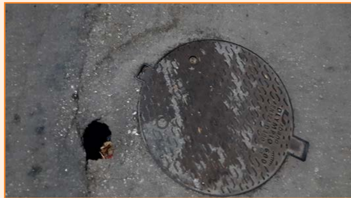
Τρύπες στο οδόστρωμα και κακοτεχνίες
