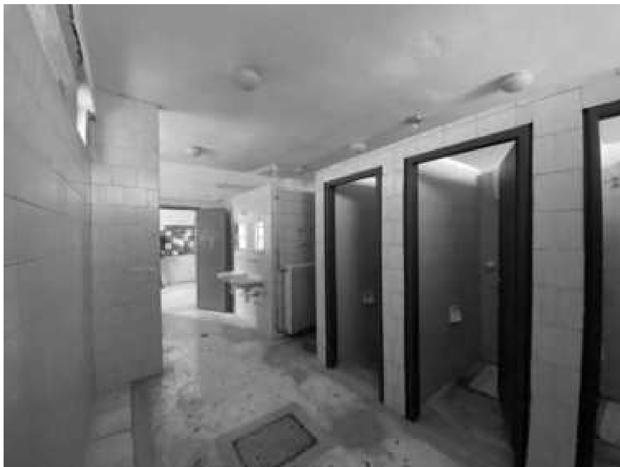
Εικόνα 175: Χώροι υγιεινής ανδρών και χώρος αποθήκης
