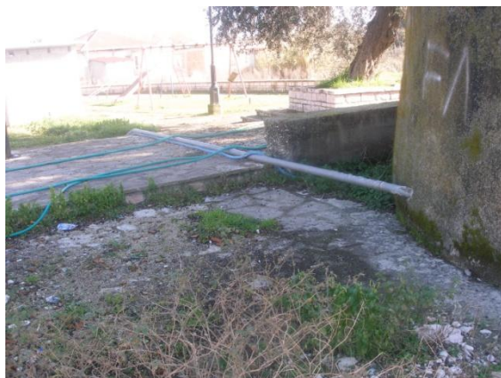
Σύνδεση γεώτρησης με υδατόπυργο
